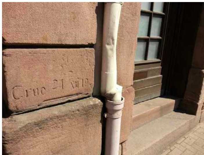
Figure 7 : Repère de crue de la crue du 24 décembre 1919 à La Broque.
